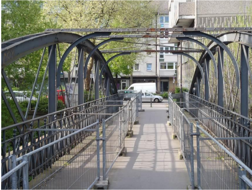
Abbildung 22: Sanierungsbedürftige Brücke Pfälzer Steg
