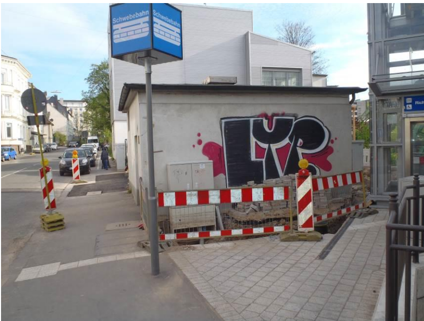
Abbildung 24: Trafostation der WSW Energie & Wasser AG
